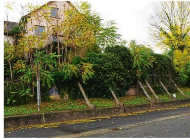
Baulich marode und inzwischen auch zugebaut: Für die Beseitigung der Stützmauer unter dem alten Stadtwerk-Domizil sind Planungsmittel vorgesehen.
