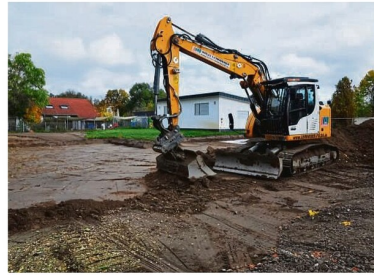
Bisher nur eine flache Grube, bald die neue Kita am Stadion: Dieses Vorhaben soll nächstes Jahr den Löwenanteil der Investitionsmittel im Seligenstädter Etat beanspruchen.
